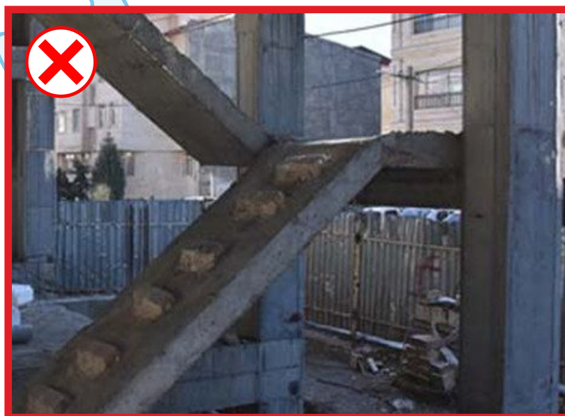
شکل ۱۹-۱: استفاده نادرست از آجر و ملات جهت ایجاد پله دسترسی
